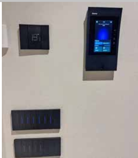
Steuerung Smart Home
